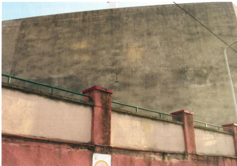
Abbildung 19 Eine ungedämmte Außenwand mit Wärmebrücken durch die Fugen
