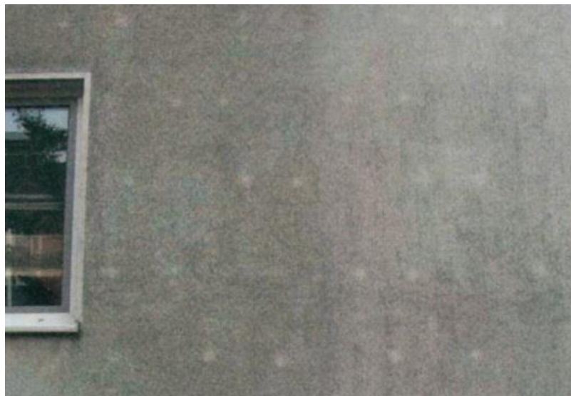
Abbildung 20 Materialbedingte Wärmebrücke durch Tellerdübel im WDVS
